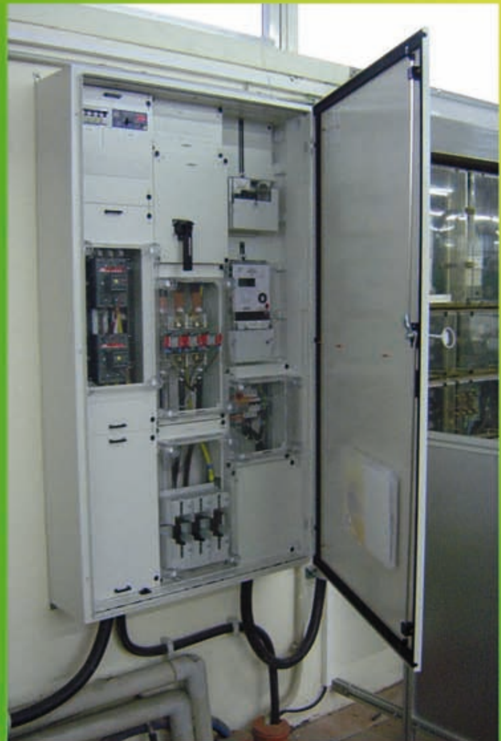
Wandlerfeld für Energieübertragung und Einspeisemanagement
