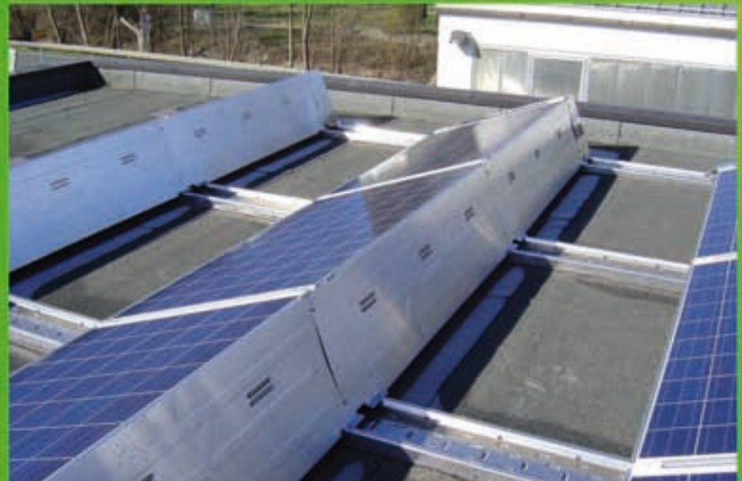
Fertig montierte PV - Module
