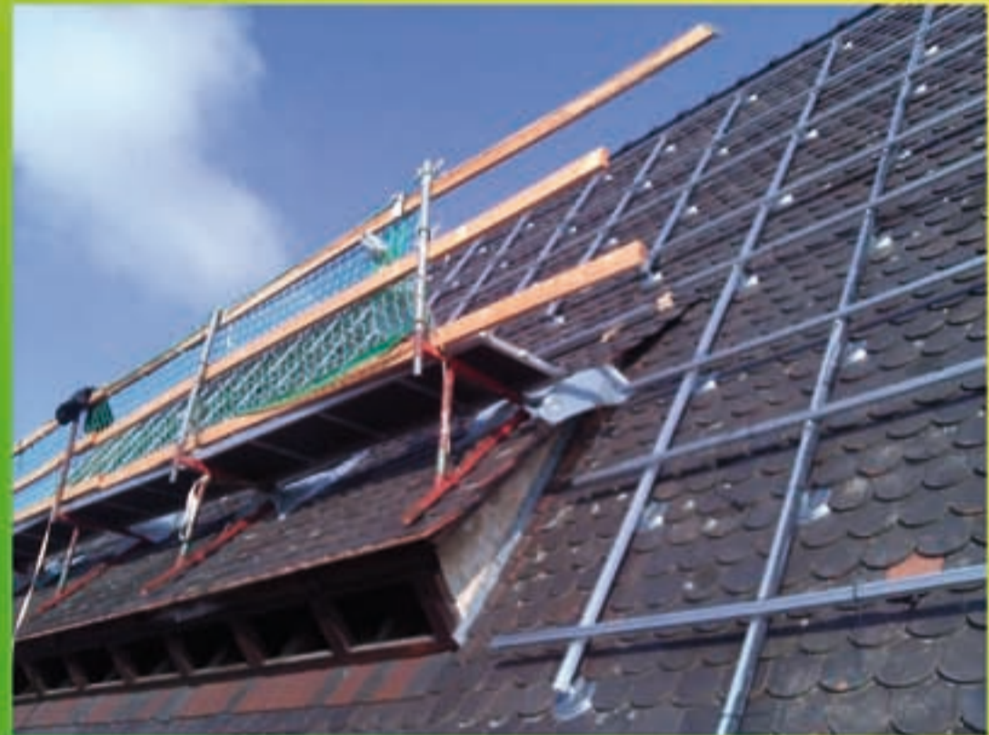
Aluminium - Untergestell für PV - Module auf der Hopfenscheune
